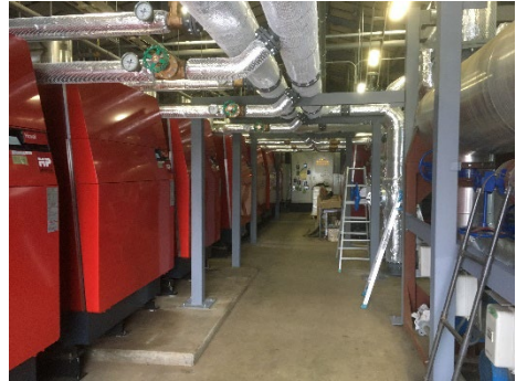
図4 エア・ウォーター農園殿 千歳農場機械室
