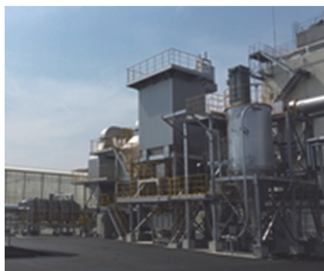
図1 t-CarVe 外観 (SARA パワー発電所殿納入設備)
